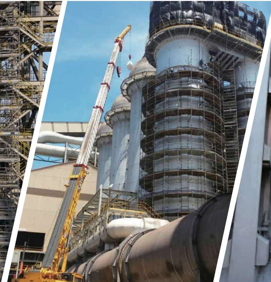
中龍熱風爐 DSC Hot blast stove
