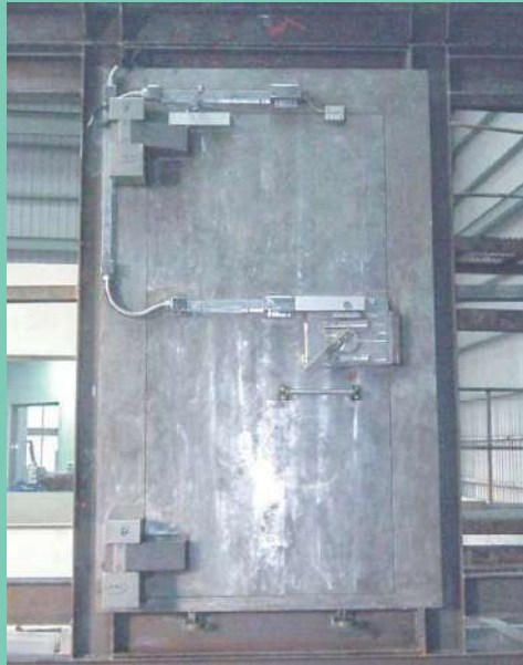
台電龍門電廠核能級防爆特殊門新建 TPC Lungmen Explosion proof door
