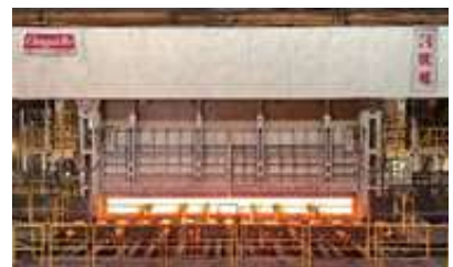
中鋼 Y41 #3 加熱爐 CSC Hot strip Mill Reheating furnace
