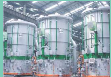
中鋼 全氫退火爐 CSC Hydrogen batch annealing furnace
