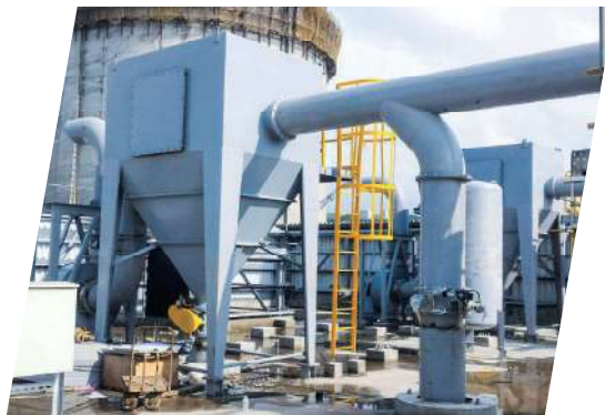
林口電廠袋式集塵機 TPC Linkou Bag filter
