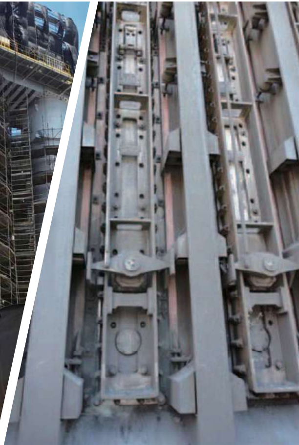
煉焦爐爐門框 Coke oven door frame
