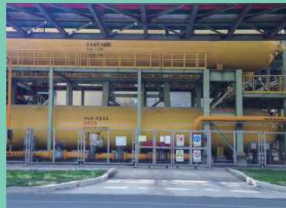
中龍 氮氣儲槽 DSC Nitrogen tank
