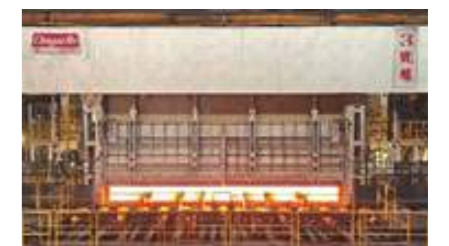
中鋼 Y41 #3 加熱爐 CSC Hot strip Mill Reheating furnace
