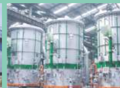
中鋼 全氫退火爐 CSC Hydrogen batch annealing furnace
