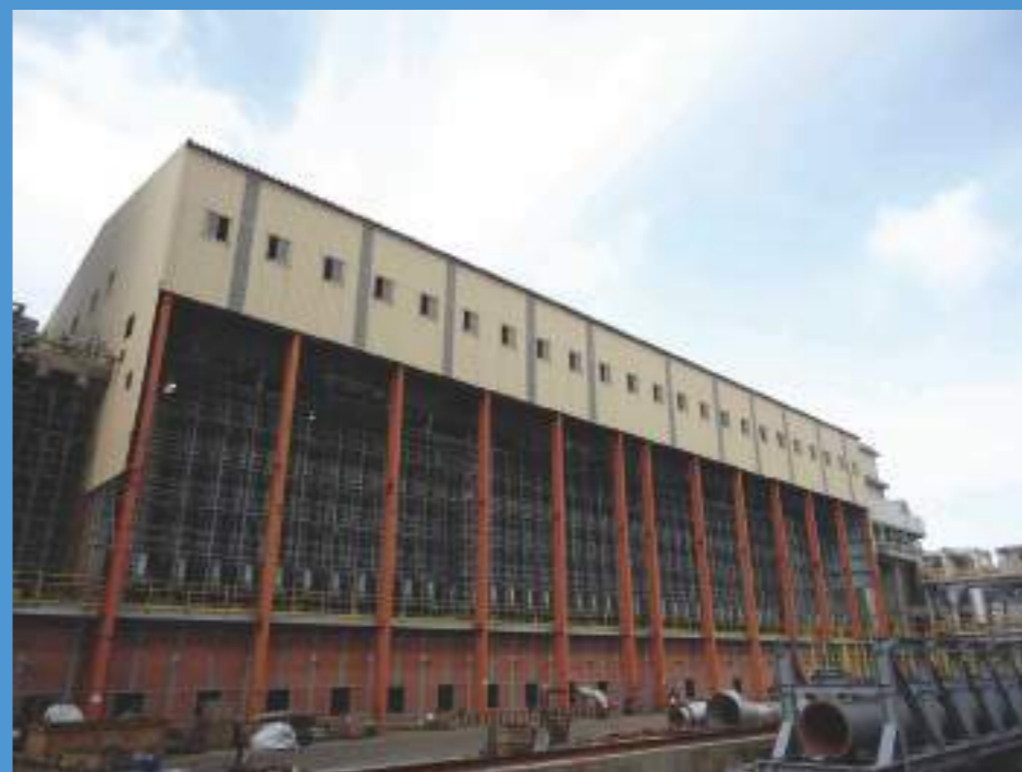
中龍煉焦爐 DSC coke oven
