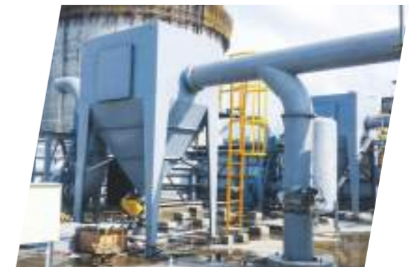
林口電廠袋式集塵機 TPC Linkou Bag filter
