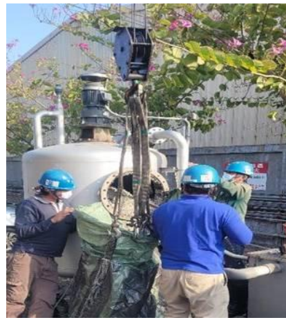
定期濾材更換
